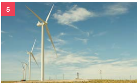
Aerogenerador. Fuente: YPF
